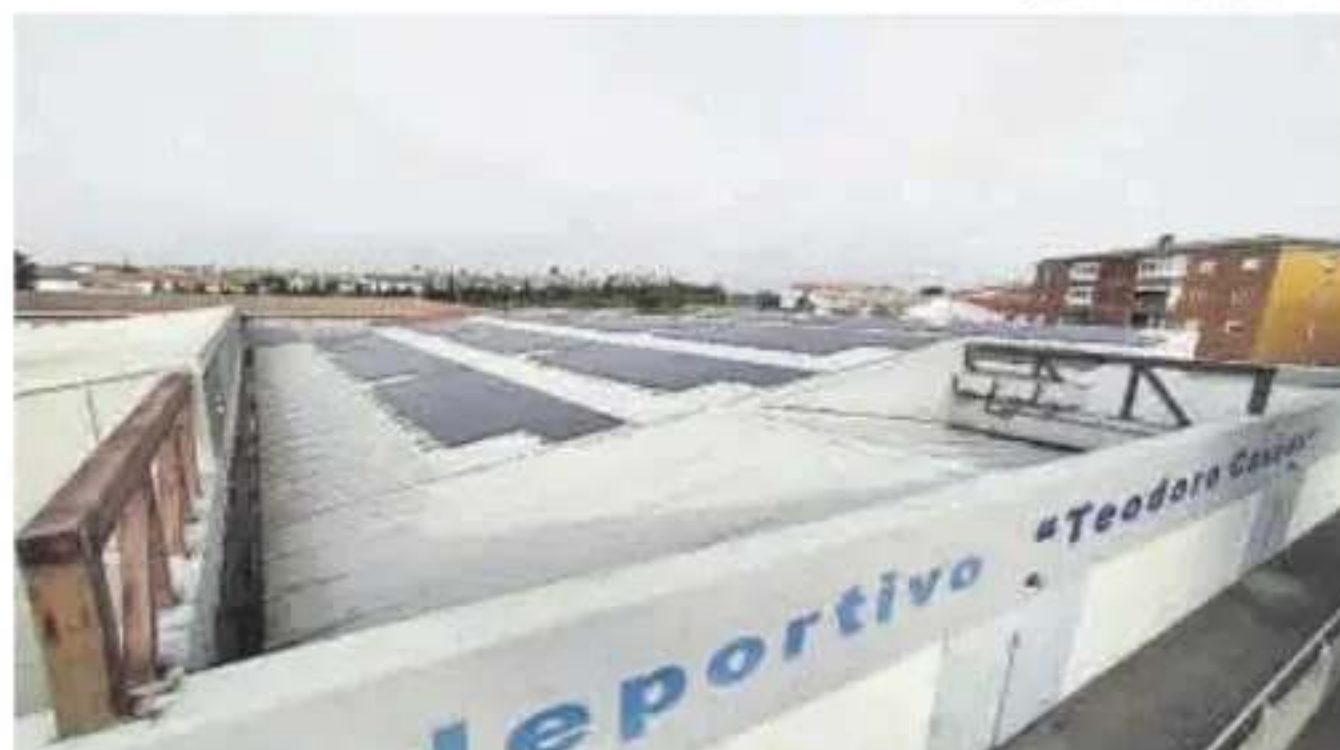
Tejado del pabellón El Vivero, que se reparará.
