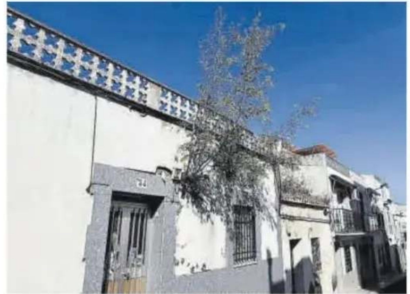
Los vegetales emergen con fuerza de la pared principal del inmueble.
