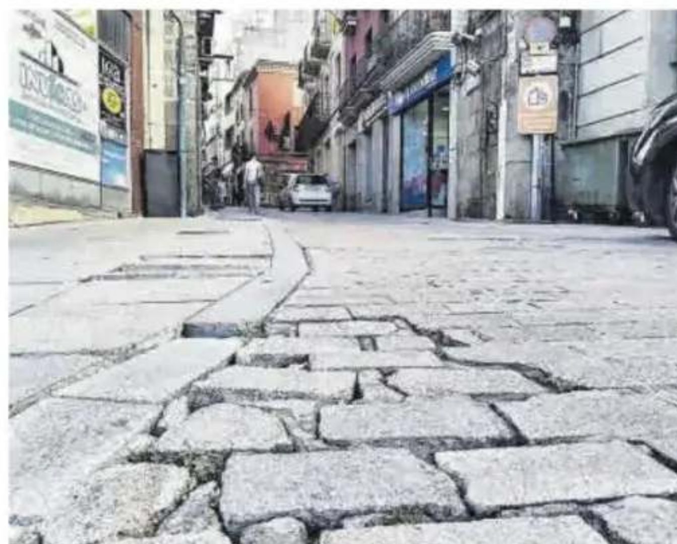
Pavimento en mal estado, donde se ha caído el hombre.
