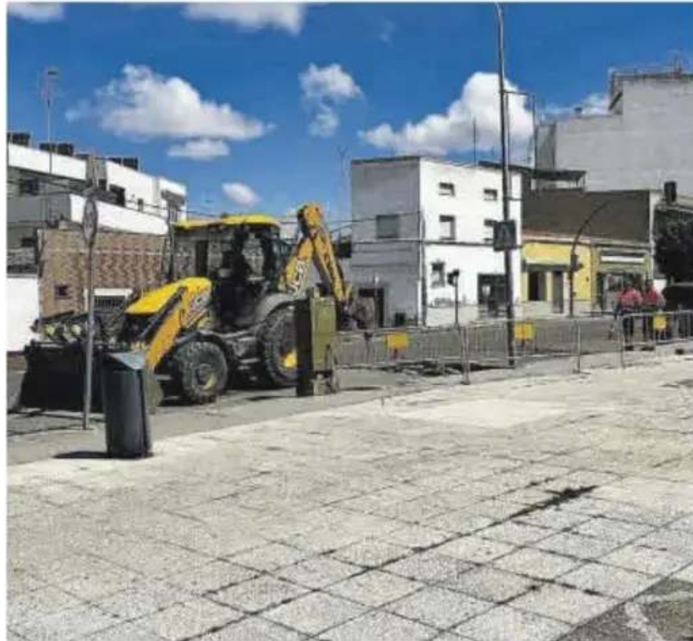
Zona de la carretera de Santa Marta donde se produjo la avería.
